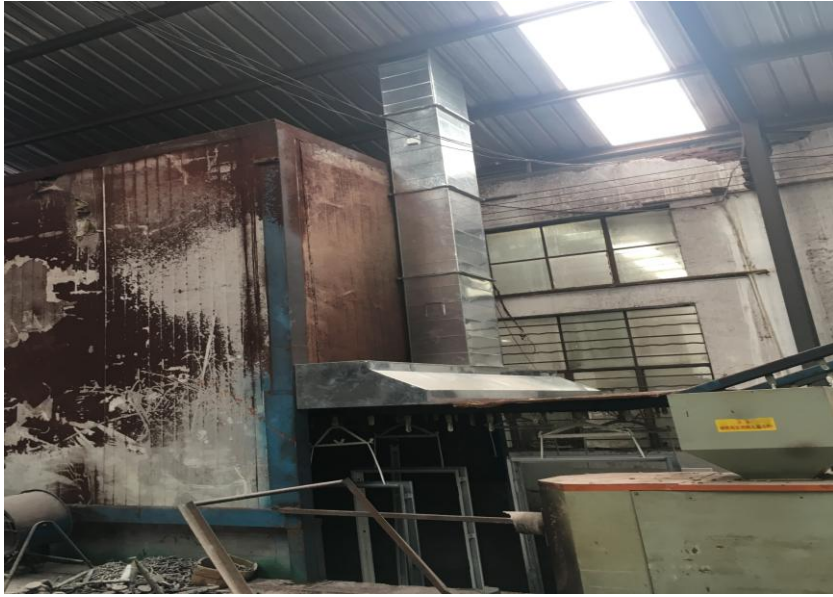
图4-4 天然气燃烧废气/固化废气收集设施图
