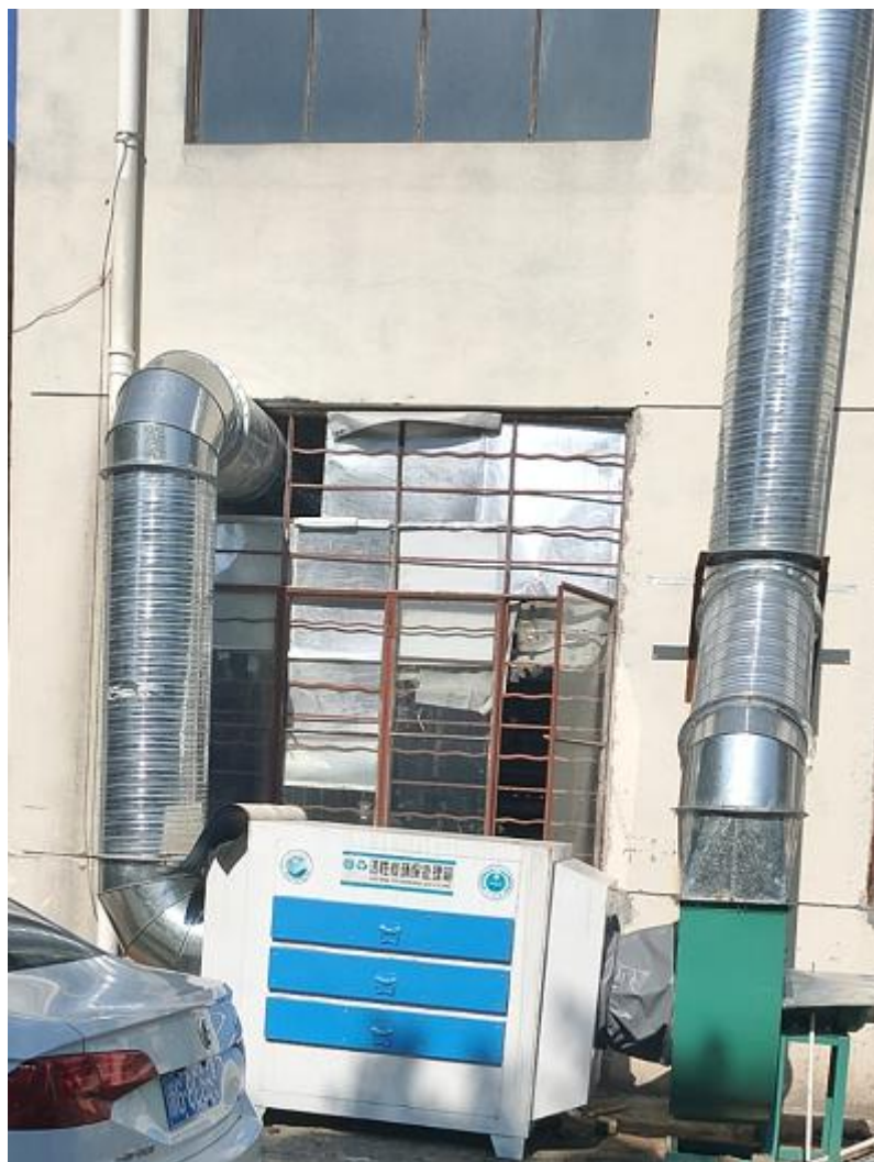
印刷废气处理设施
